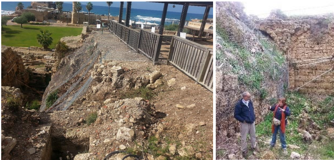
איור 13. רשת הגנה במדרון ובחתך חפירה, קמרון הנמל בגן לאומי קיסריה
